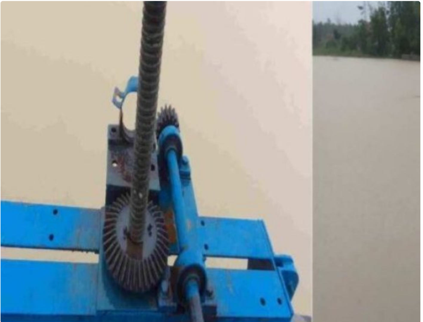
Pintu air Albaret Simpang Mesuji
